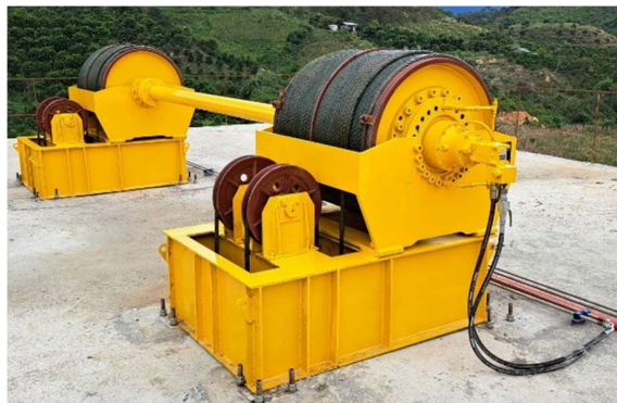
Hình 12. Tời thủy lực lắp đặt vận hành tại công trình thủy điện Nam Long (Đăk Nông)
