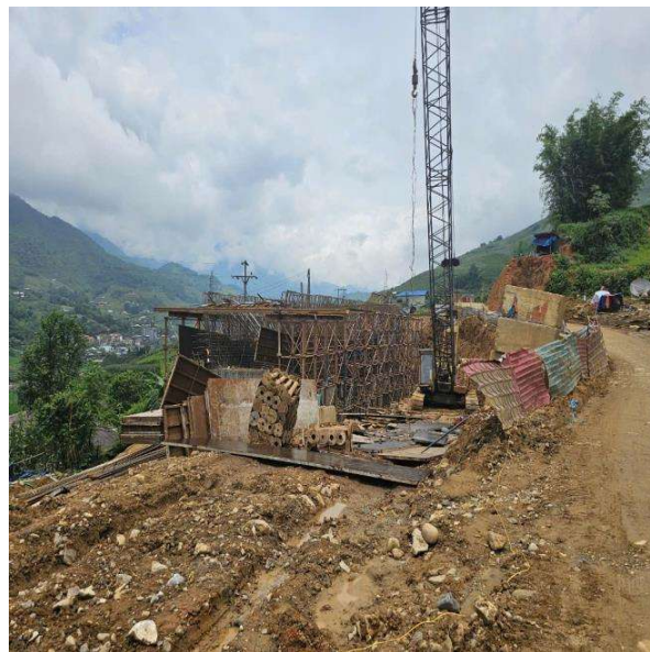
Hình 4. Hình ảnh một điểm trượt lở của đường nông thôn ở Sapa, ảnh chụp tháng 6/2024.
