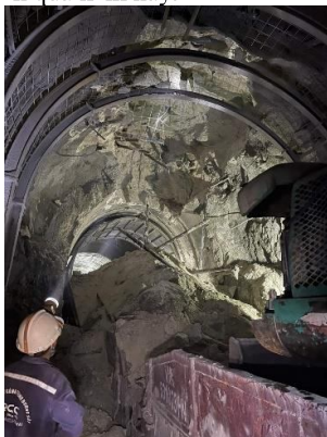
Hình 1. Sạt lở hầm Chí Thanh - Tuy An, Phú Yên
