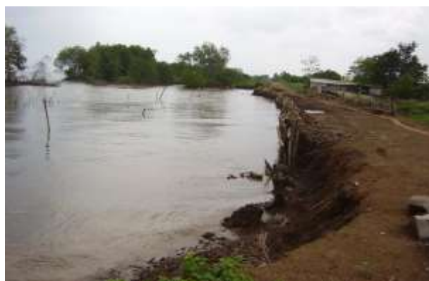
Hình 1. Sạt lở đê tại đoạn kênh 286 - Vàm Rầy, tuyến đê Chùa Hang - Rạch Giá
