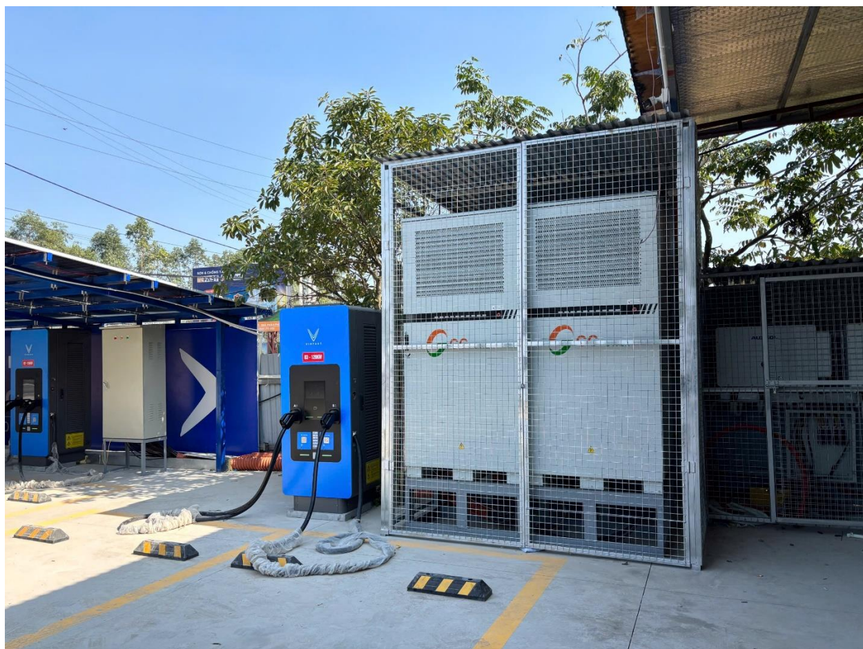
Hình 2. Hệ thống BESS 522 kWh kết hợp hệ thống Solar 220 kWp tại Trạm sạc xe điện ở Bá Hiến, Phú Thọ.
