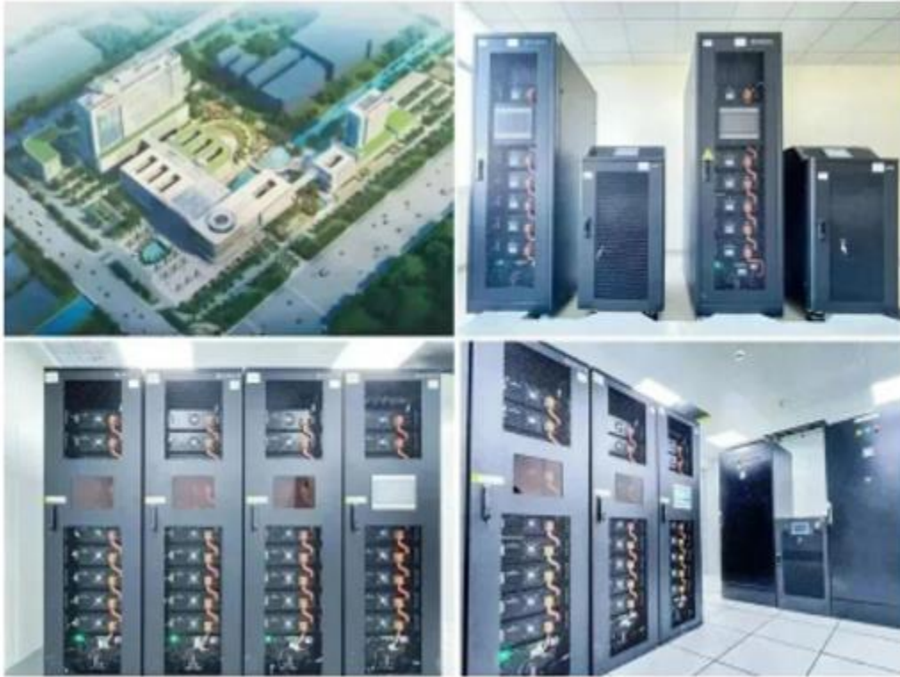
Hình 4. Dự án hệ thống lưu trữ năng lượng (Bess) tại Bệnh viện Kushan
