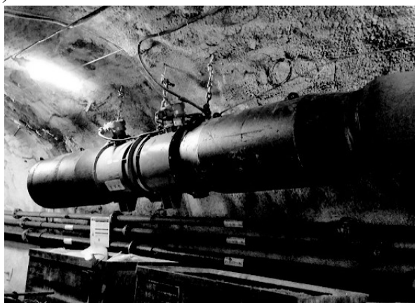
Hình 2. Bộ tiêu âm lắp đặt trên nóc lò
