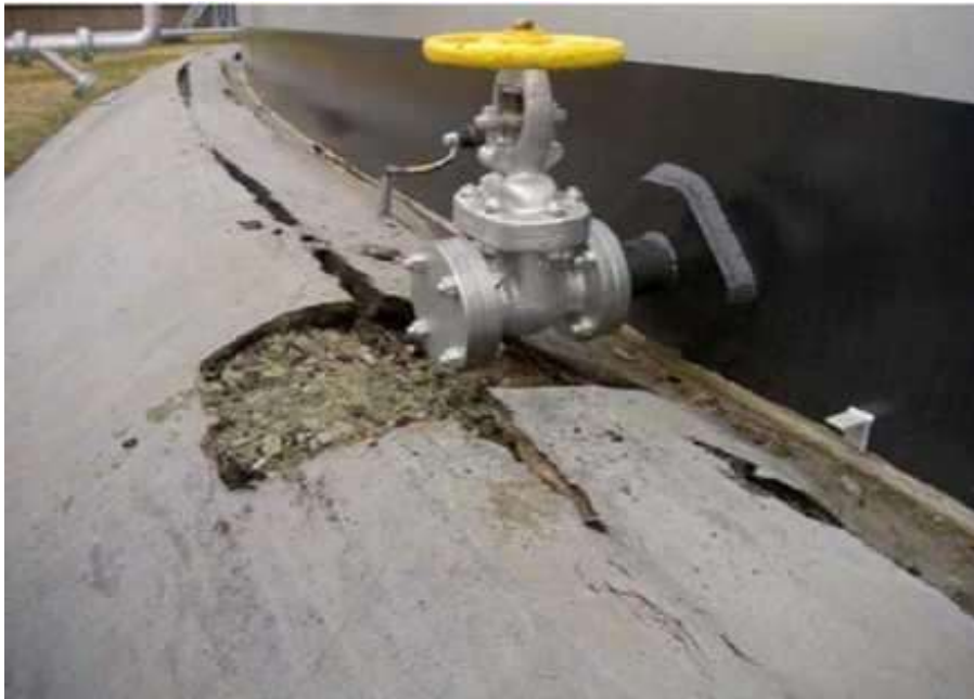
Hình 6. Bể chứa tại Iwaki bị lún do hiện tượng hóa lỏng đất xung quanh móng (Zama và nnk., 2012).
