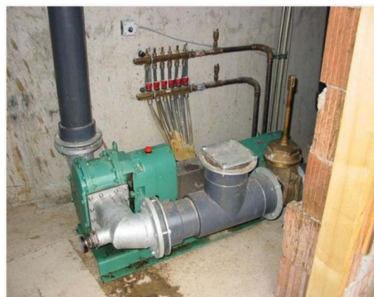
Hình 1. 6 Bơm thủy trong hệ thống làm sạch chất thải trong bể dự trữ
