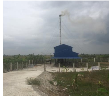
Hình 3.6. Lò đốt chất thải sinh hoạt xã Trục Hùng, huyện Trục Ninh, tỉnh Nam Định
