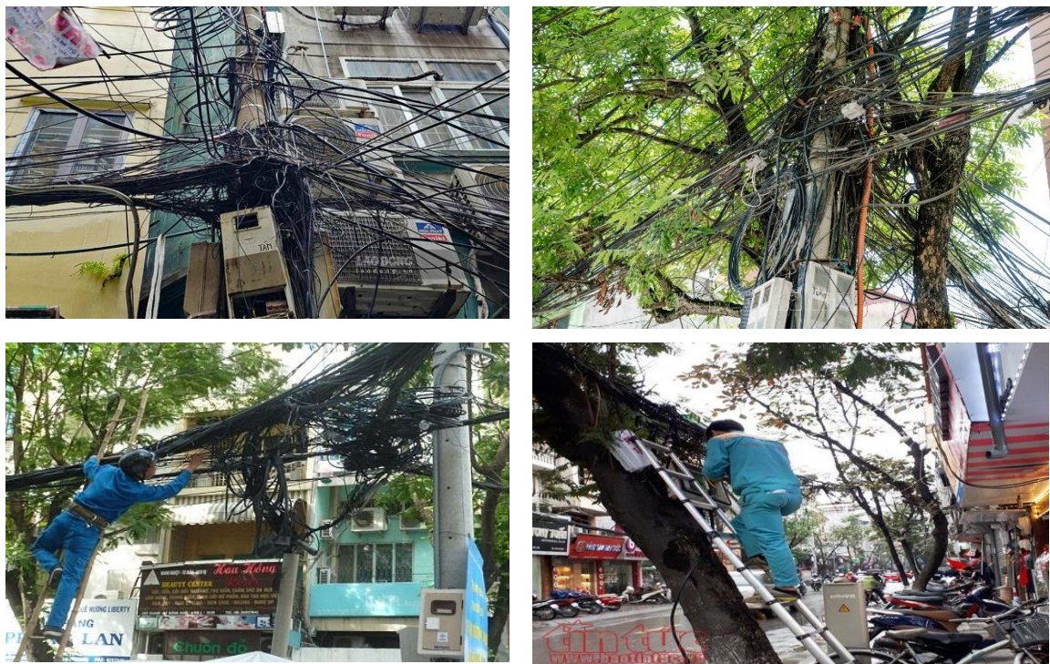
Hình 2.6. Hiện trạng đường điện, cấp kỹ thuật gây mất an toàn, mỹ quan
